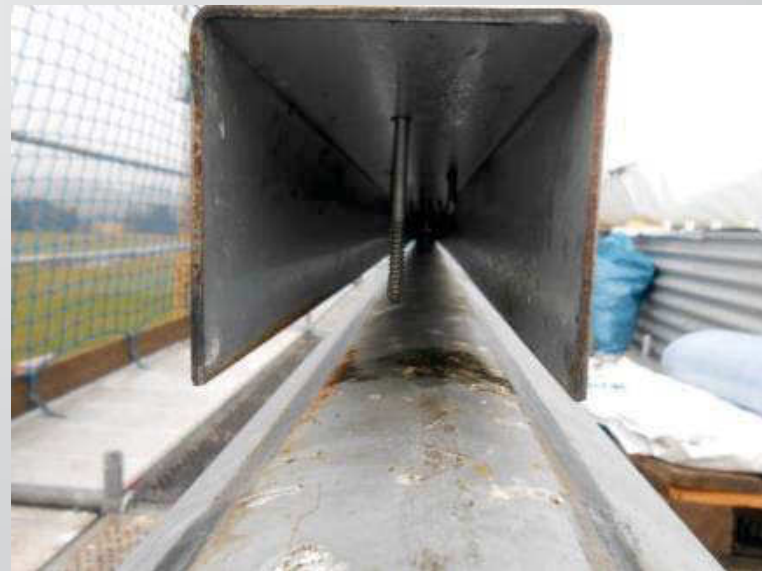
Ermüdung des Dachhalteprofils
